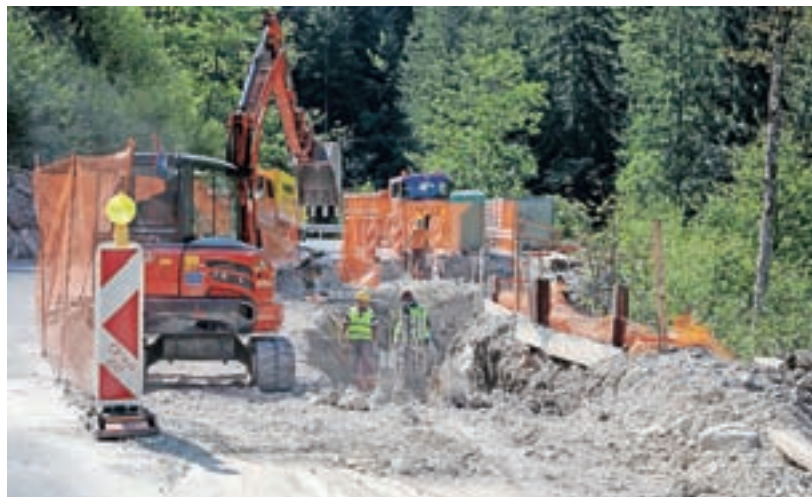
Sanacijo usada na državni cesti v Davčo naj bi končali do konca oktobra.
